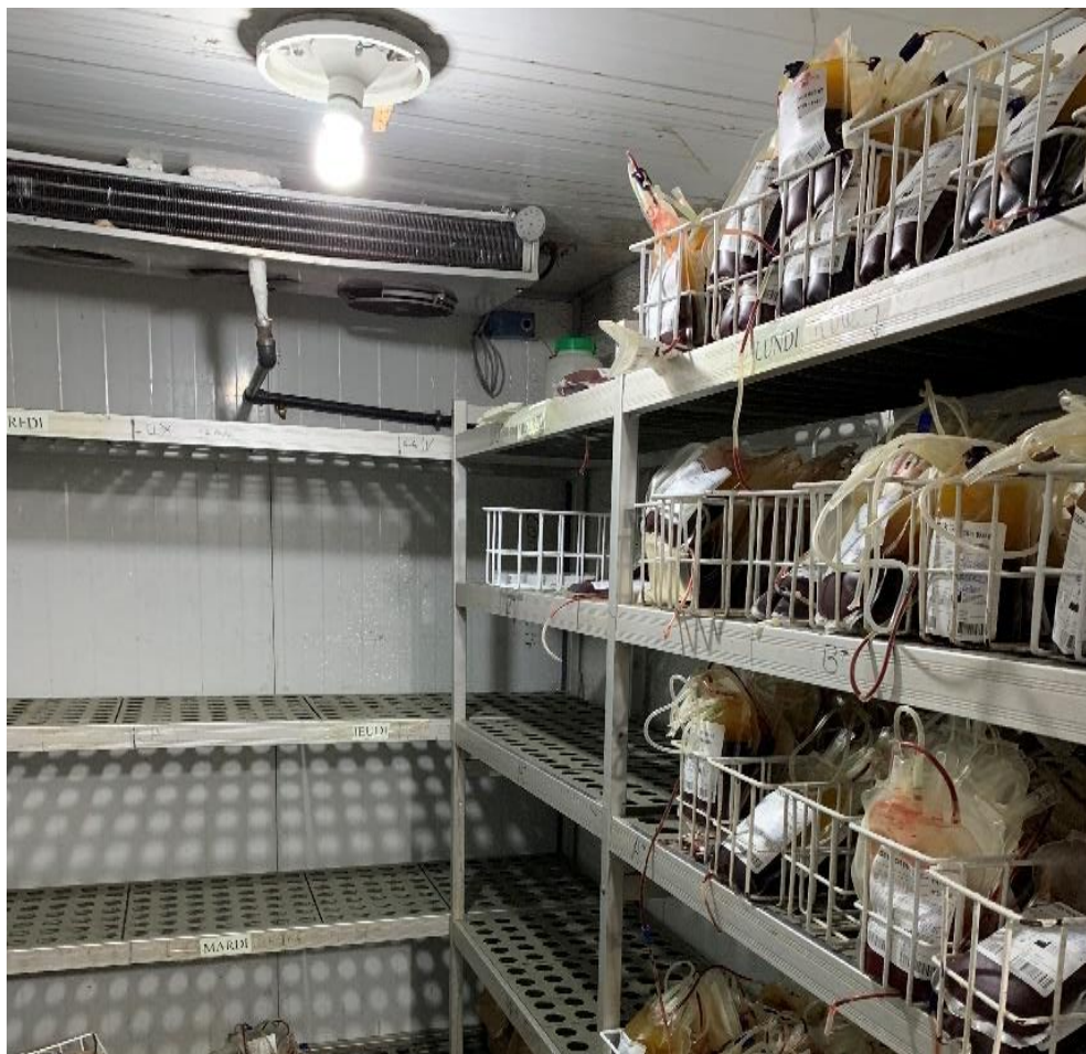
Figure 10 : L'intérieur de la chambre froide (photo prise au CNTS)
